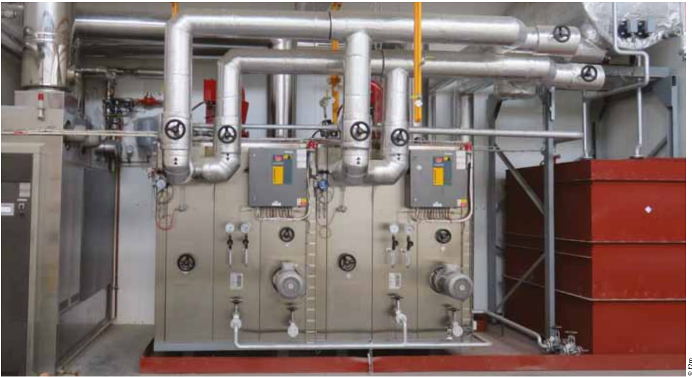
+++ Двойная котельная установка печи с масляным теплоносителем мощностью 1000 кВт, слева – установка регенерации тепла Ekoblok, справа – запасной резервуар для масла
